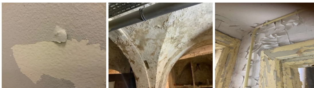
Foto 1: Slechte hechting van het muurverfsysteem.
